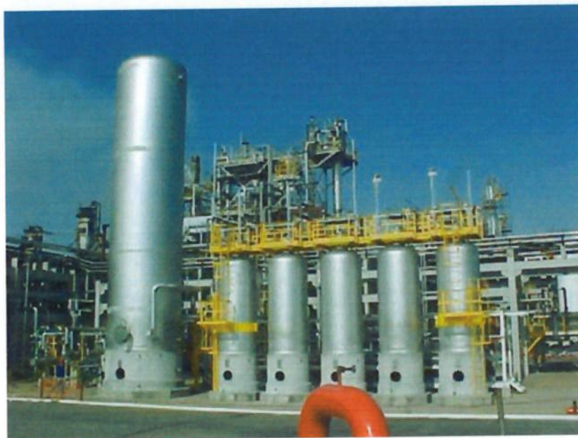
Fig. 2.2 – Sistema de purificação (PSA)
